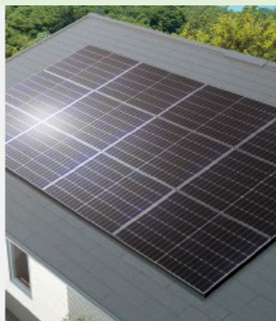
太陽光発電・蓄電システム
