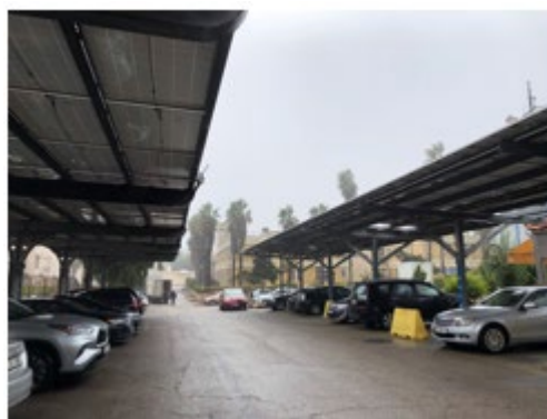
政府機関の駐車場にはことごとく太陽光パネルが設置されている。EVも数多く駐まっている
